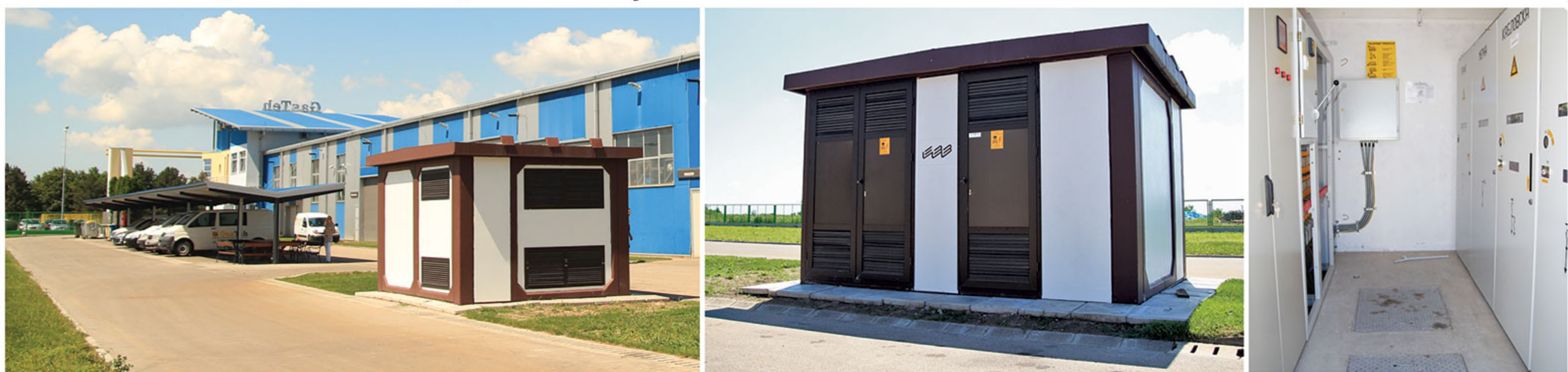
MBTS 20/0,42 kV 1x630kVA „GasTeh“ Indija
