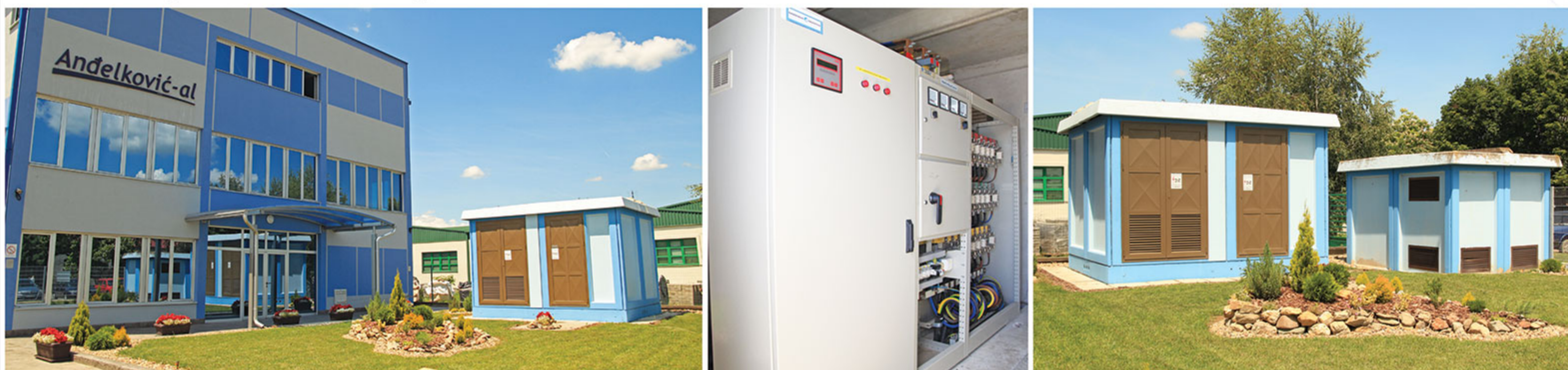
MBTS 20/0,42 kV 1x630kVA „Niksan“ Nova Pazova
