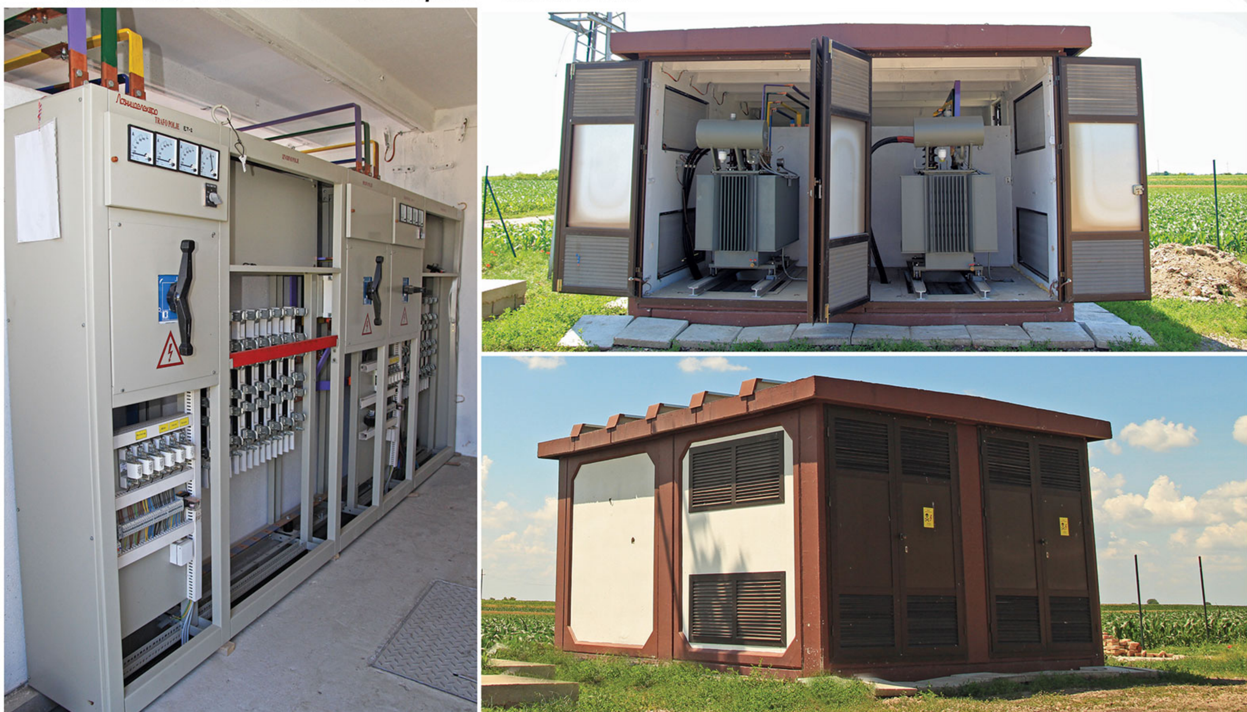
MBTS 20/0,42 kV 2x630kVA „Interplast“ Stara Pazova
